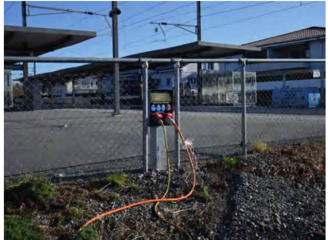
Boîtier de distribution à la gare d'Oberriet
