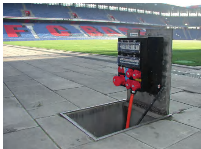
Distribution électrique souterraine, Parc St-Jacques, Bâle
