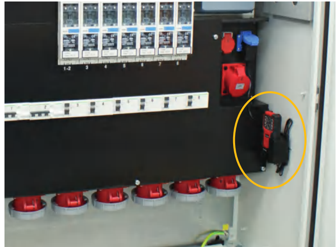
TorchLED de secours dans tableau de chantier
