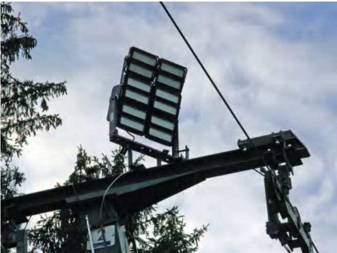
HPL 1'350W Remontées mécaniques Freistadt
