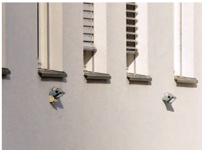
SpotLED 230 comme éclairage extérieur d'un bâtiment administratif
