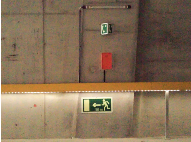
Richtungsanzeige für Fluchtweg
