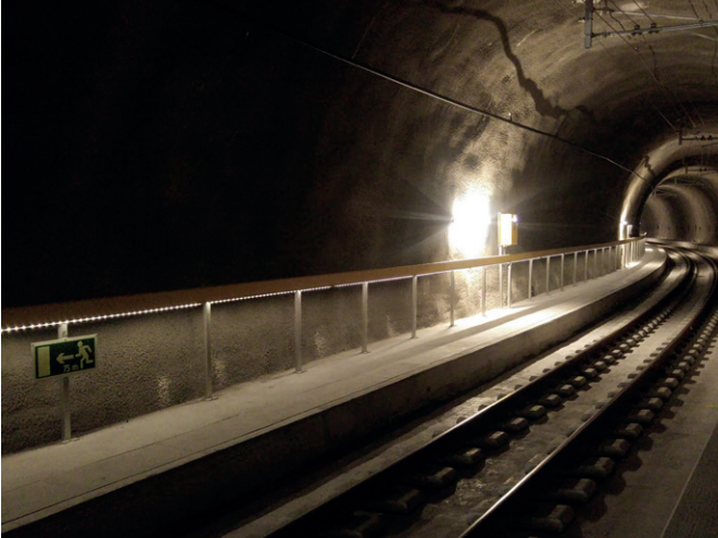
Installation Tunnel Rückhalde Appenzeller Bahnen
