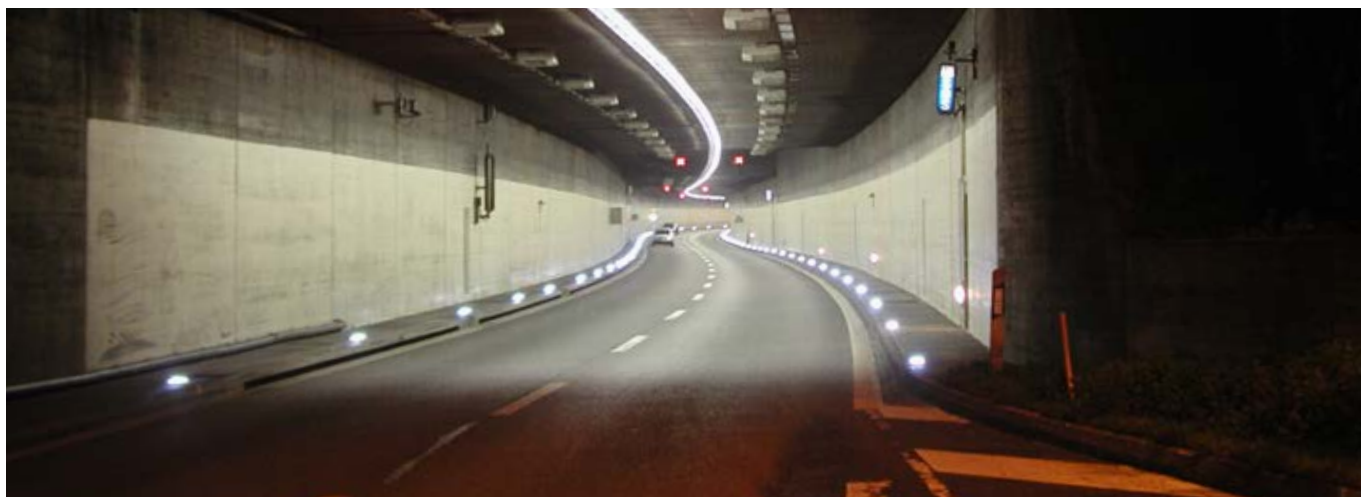
Unità di segnalazione nel garage FHS di San Gallo
